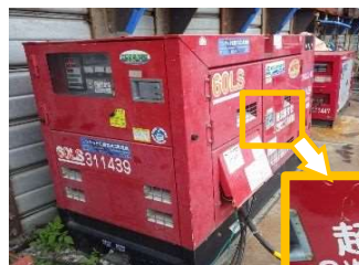
排出ガス対策・振動の措置された発電機
