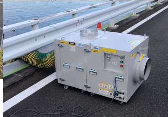
集塵装置の設置
